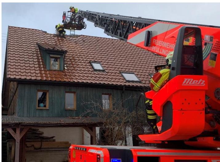
Abbildung 26: Überlandhilfe Sonnenbühl - Dachstuhlbrand
