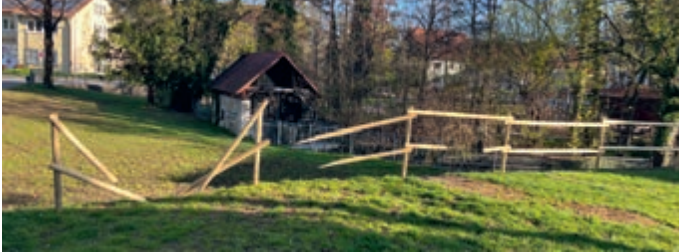
Beschädigter Zaun im Schlösslespark
