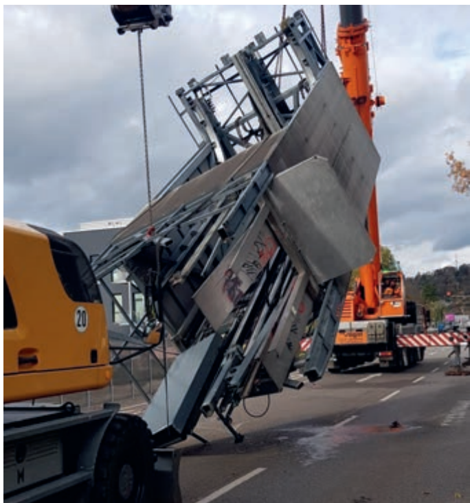
Einer der beiden Türme in Schräglage.
